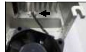
Fan power disconnection
