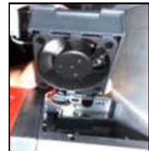
Fan power connection
